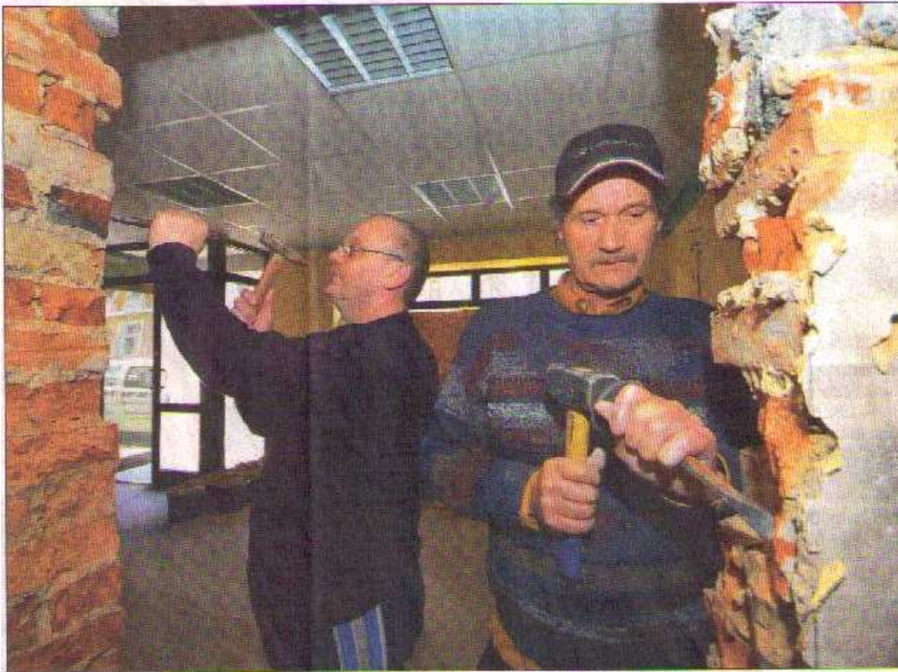
Helge Winkler (l.) und Hans-Udo Bartels haben noch viel zu tun, um die Räume bis zum Juni herzurichten. Hier bereiten sie gerade Wände für die Küche vor.
